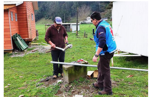
Instalación de una antena en la Comunidad Mississippi, Región de Los Ríos, 2014
